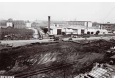
Chantier du futur Centre sportif universitaire. Photo de Charles Heitz datée du 20 septembre 1968. Source : Rectorat.
